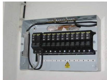
ข. คอนซูมเมอร์ยูนิต
