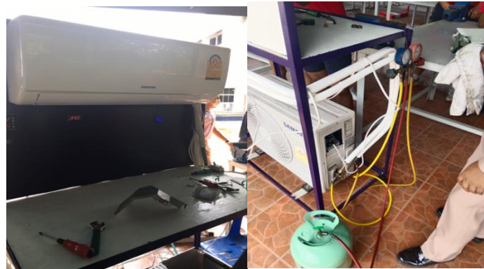
ภาพที่ 8 การทดลองเซ็นเซอร์ การเติมน้ำยาแอร์
