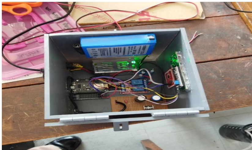
รูปที่ 3.6 นำบอร์ดลงกล่องสำเร็จ
