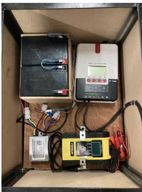
รูปอุปกรณ์ภายในตู้รวมสามล้อพลังงานแสงอาทิตย์
