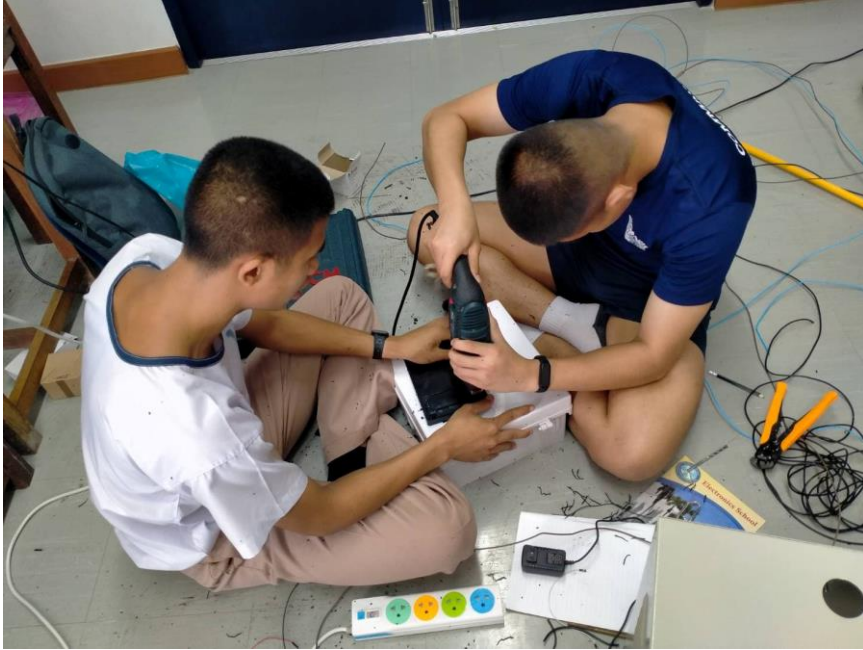
ภาพที่ 3.4.4.2 ทำการเจาะรูเพื่อติดตั้ง หลอดไฟ LED นาโน และ LCD
