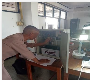
รูปที่ 3.11 ทดลองเปิดไฟเพื่อดูแบตเตอรี่
