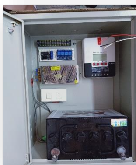
รูปที่ 3.13 ทดลองการต่ออุปกรณ์กับกล่องควบคุม
