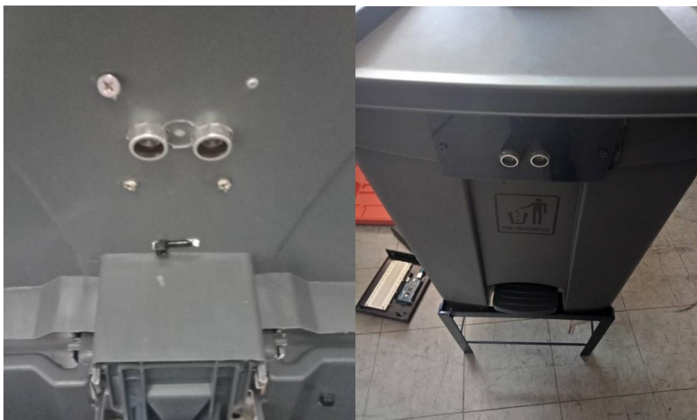
3.3.1.1 การติดตั้งเซนเซอร์ วัดระยะทางในตัวถังขยะ
