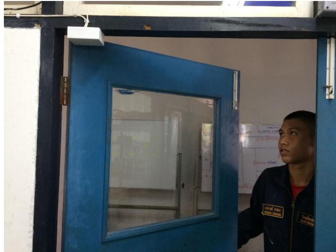
รูปที่ 4.1.2.8 ทดสอบการทำงานของระบบเตือนภัย
