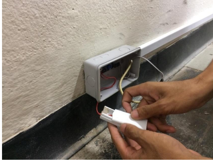
รูปที่ 4.1.2.5 ติดตั้งเซนเซอร์ Water flood
